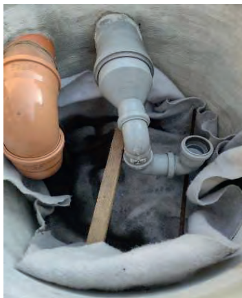
Filter für den Zulauf in die Zisterne. Dieser wird einmal jährlich gereinigt. Foto: Manfred Rhöner
