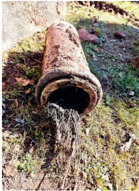
Gut erkennbar die eingewachsenen Wurzeln
