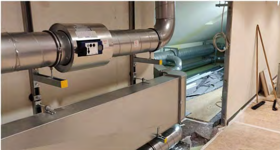
Neubau und Altbau wurden an die coronagerechte und hochmoderne Belüftungsanlage angeschlossen.
