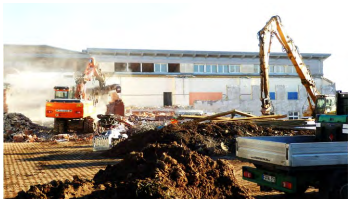
Der Abriss der alten Schule war unvermeidlich und machte den Weg frei für eine zeitgerechte und moderne Planung.
