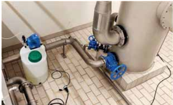
Der kleine runde Behälter links im Bild ist das Dosiergerät, mit dem die Chlorbleichlaugung dem Trinkwasser beigemischt wird.
