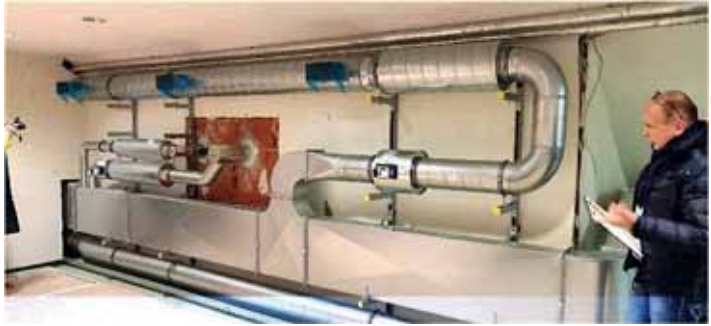
Das Bild zeigt einen „kleinen“ Teil der aufwändigen Lüftungstechnik. Hier im Turnraum im Dachgeschoss. Die Rohre sollen im Zuge des weiteren Ausbaus hinter einer Vorbauwand verschwinden, an der dann ein Klettergerüst angebracht wird.
