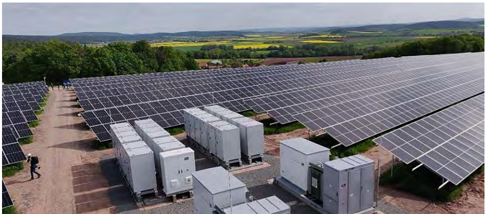
Blick über einen Teil der Anlage Richtung Querbachshof. Im Vordergrund die Stromspeicher.
