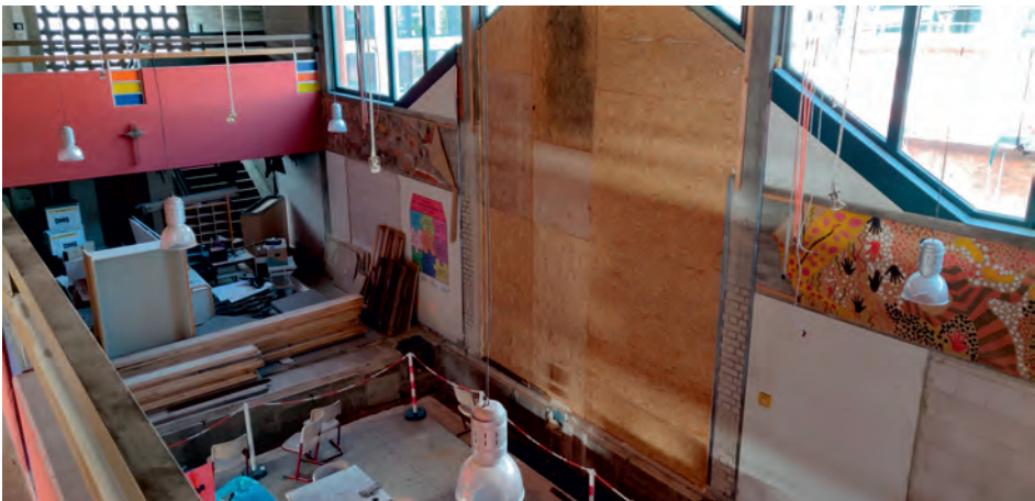
Blick in die ehemalige Aula. Gut erkennbar der mit Spanplatten verschlossene Durchgang in den abgerissenen Anbau. Mit Absperrband gesichert der Schacht für die Versorgungsleitungen.
