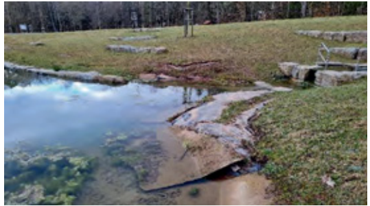
Verursacht durch Setzungen kam es im Einlaufbereich zu Abbrüchen und Rutschungen.
