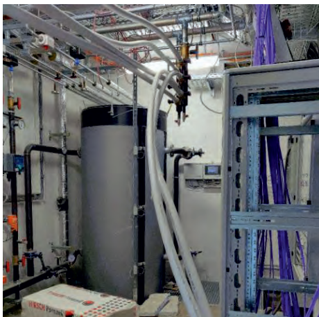
Einer von zwei Technikräumen in der EGS
