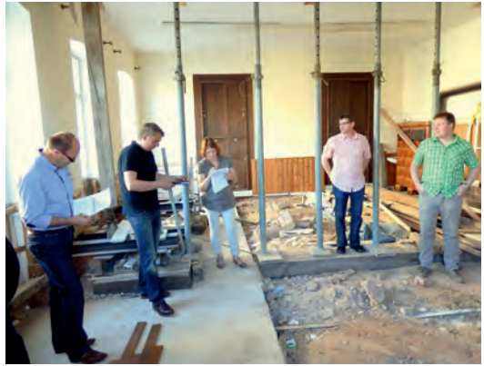
Die statische Sicherung des Gebäudes stand im Vordergrund. Der alte Schulsaal wurde dabei stark in Mitleidenschaft gezogen.
